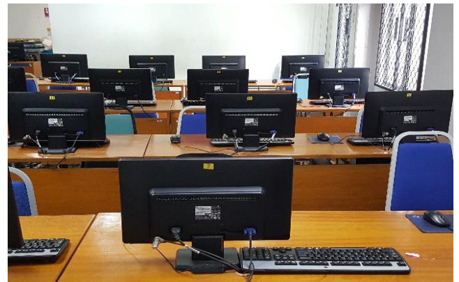
Pendawaian/kabel yang kemas dan selamat
